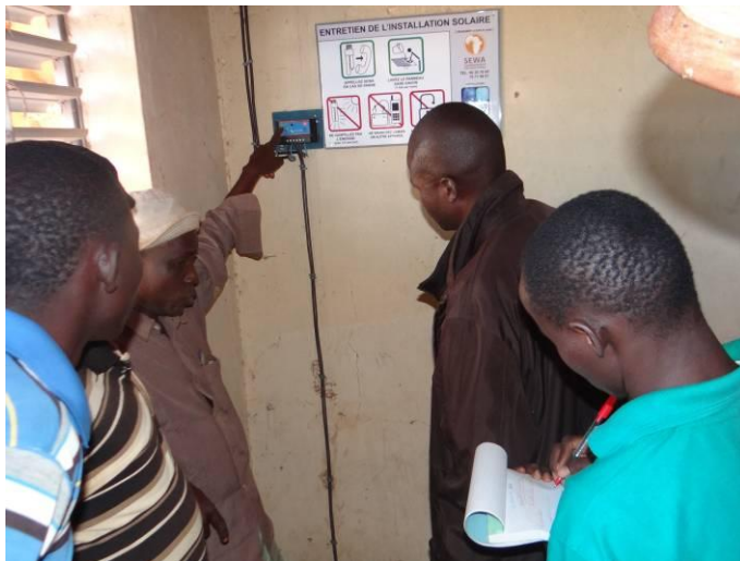
Die Lehrer werden in Gebrauch und Wartung der Anlage eingewiesen. Die wichtigsten Informationen sind gleich neben dem Laderegler angebracht
